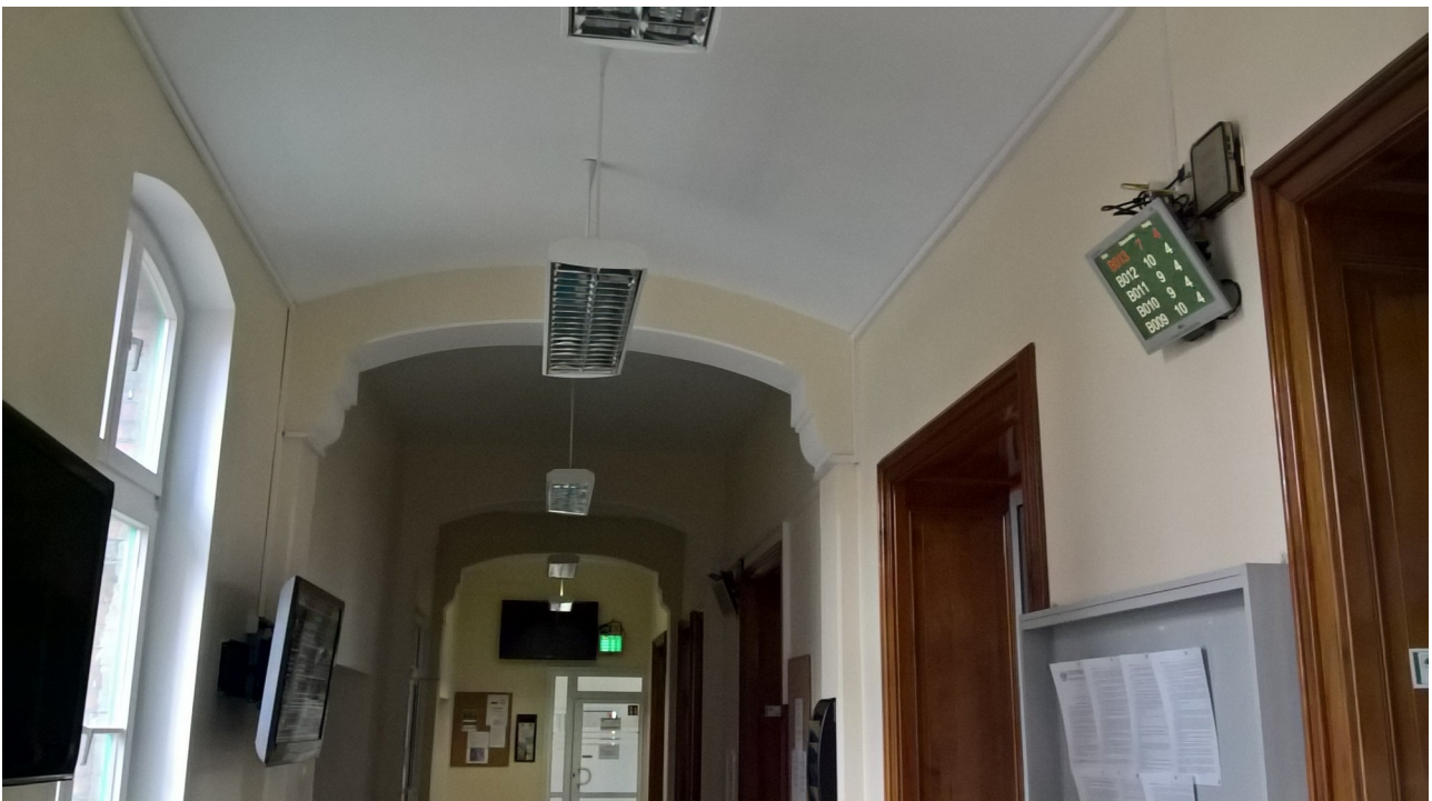
Zbliżenie miejsca montażu wyświetlacza na parterze
